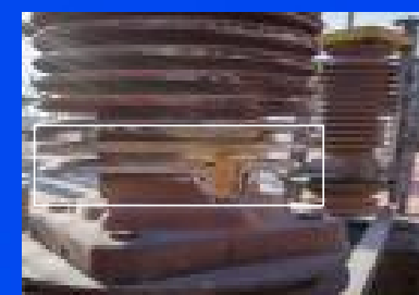
设备破损检测
